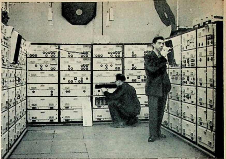
Het hart van de lijnentransformator.
